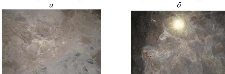
Рисунок 2 – Выявленное шелушение: а) на гор. +850 м в штреке Северный б) на гор. 820 м, штр. Южный
