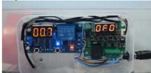
Рисунок 1 - Общий вид установки
