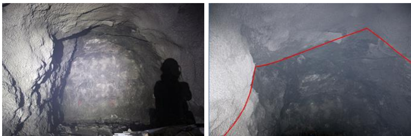
Рисунок 4.9 - Фото объекта исследования с выделением подсекающей крутопадающей трещины
