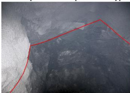
Рисунок 1 - Кровля подводящей выработки к РС-6 (-20/-100) пересеченной закрытой трещиной
