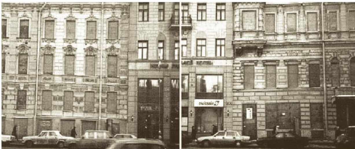
Рис. 1.8. Аварийно деформированные дома № 55 и 59 по Невскому пр.
